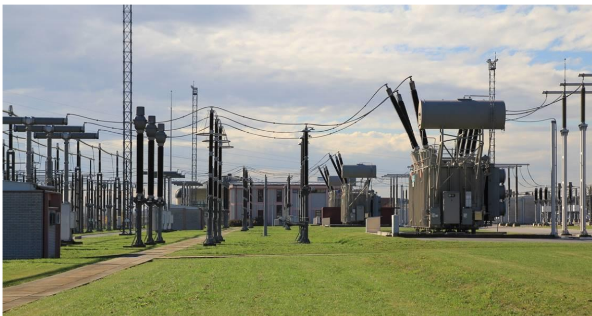
Slika 1. Položaj mjernih transformatora u odnosu na drugu visokonaponsku opremu u trafostanici
