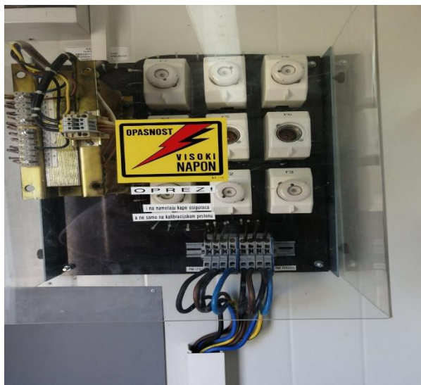
Slika 31. Glavna razvodna ploča (GRP) RD-a i ŽCP-a
