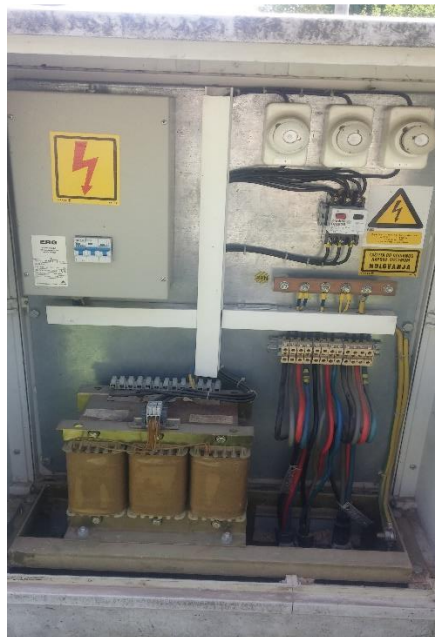
Slika 25. Kompenzator jalove energije i transformator u kolodvoru Pađane
