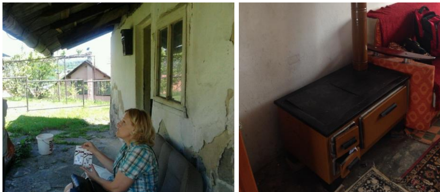
Slika 5-8 Primjeri loše vanjske ovojnice zgrade i tipičnog individualnog sustava grijanja u obiteljskim kućama (peć na drva)
