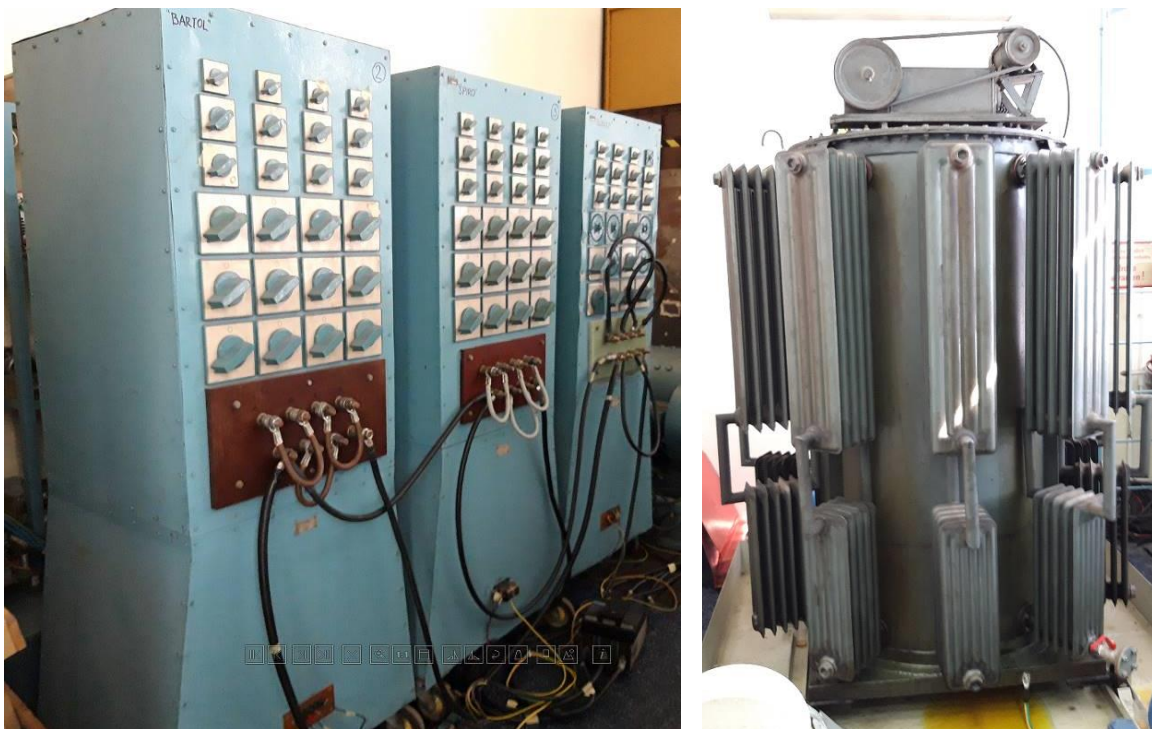
Slika 3.13 Kaskada otpornika (lijevo) i prigušnica promjenjivog induktiviteta (desno) korišteni za pasivno terećenje generatora
