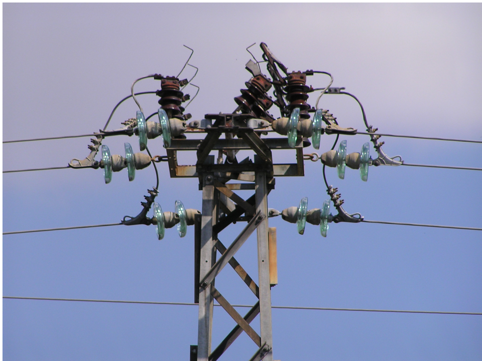
Slika 9. DV 10 kV Dubrava; linijski rastavljač
