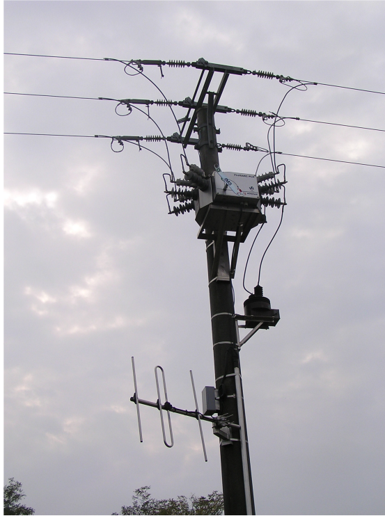
Slika 6. DV 10 kV Obrjež; linijski prekidač
