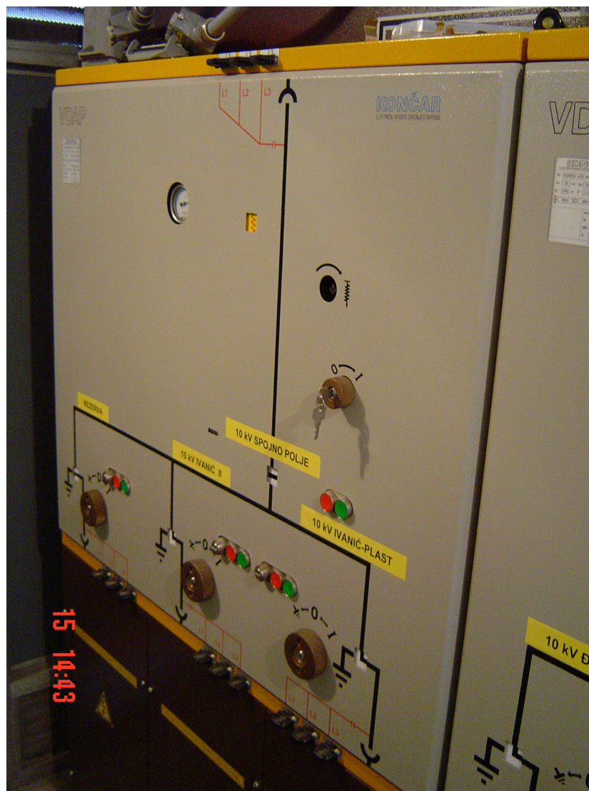
Slika 4. RS 10(20) kV Ivanić; VDA-P Blok
