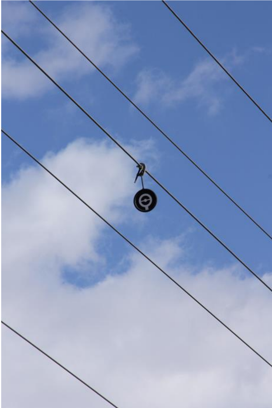
Slika 2.17 Montaža mete za snimanje provjesa i procesuiranje slike te pripadajuće ovjesne i spojne opreme
