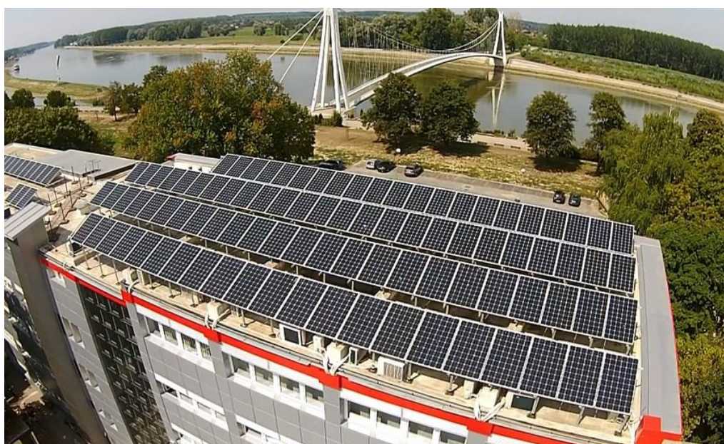
Slika 12 Integrirana sunčana elektrana [13]
