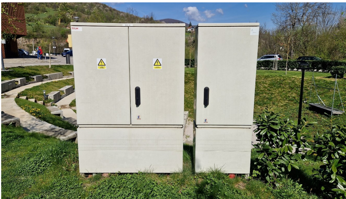
Sl. 2.6 Vanjski samostojeći razvodni ormar RO-4
