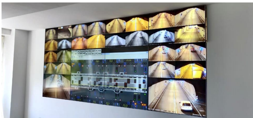
Slika 2: Video zid u kontrolnom centru tunela Učka
