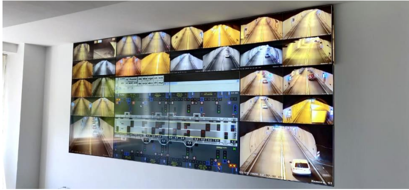
Slika 2: Video zid u kontrolnom centru tunela Učka
