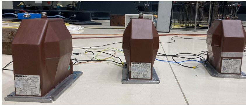
Slika 6.2: Tri induktivna naponska transformatora korištena za eksperimentalnu provjeru principa rada metode injektiranja signala
