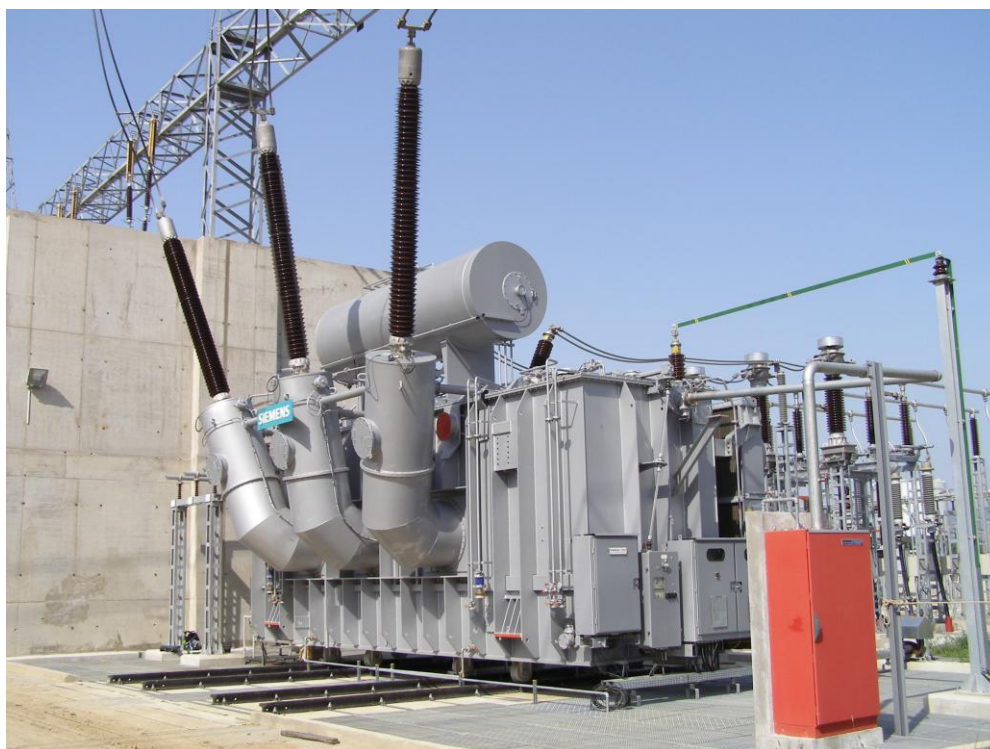
Slika 2.2 – Energetski transformator 350 MVA s provodnicima za U_m = 420 kV
