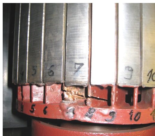
Slika G.3. Razina II oštećenja kaveza rotora
