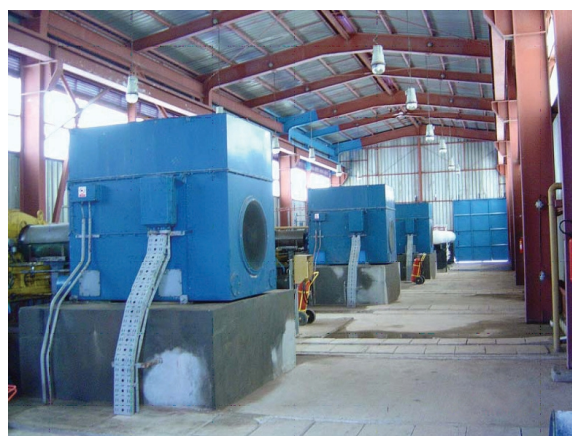
Slika A.2. „Ex e II T3“ motor, 6 kV, 1,9 MW
