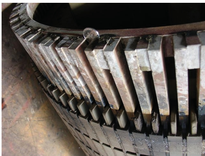
Slika E.1. Oštećenje spoja štapova i prstena
