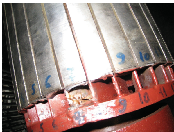
Slika G.2. Razina I oštećenja kaveza rotora
