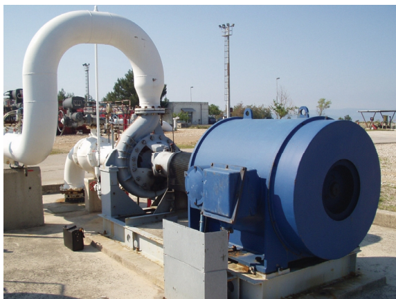
Slika A.3. „Ex de IIA T3“ motor, 6 kV, 370 kW
