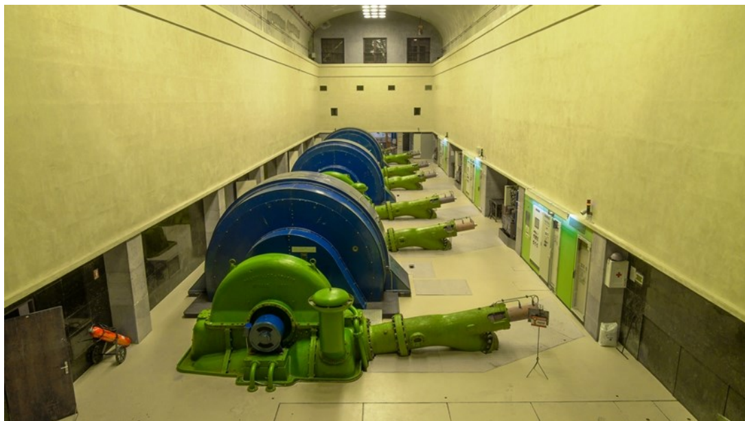
Slika 4.5: Strojarnica hidroelektrane Vinodol
