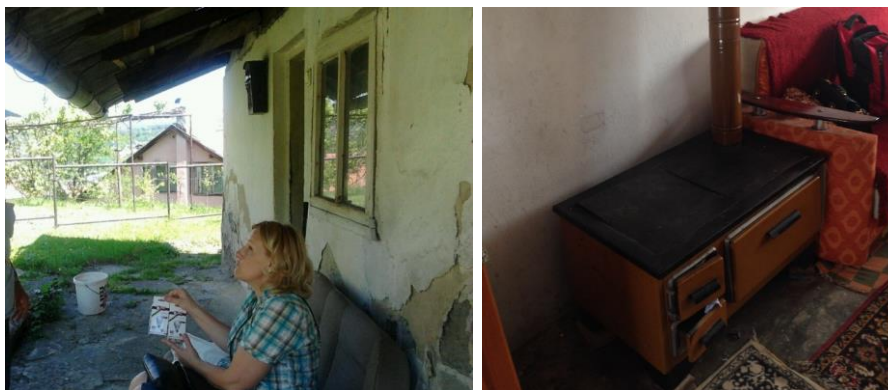
Slika 5-8 Primjeri loše vanjske ovojnice zgrade i tipičnog individualnog sustava grijanja u obiteljskim kućama (peć na drva)
