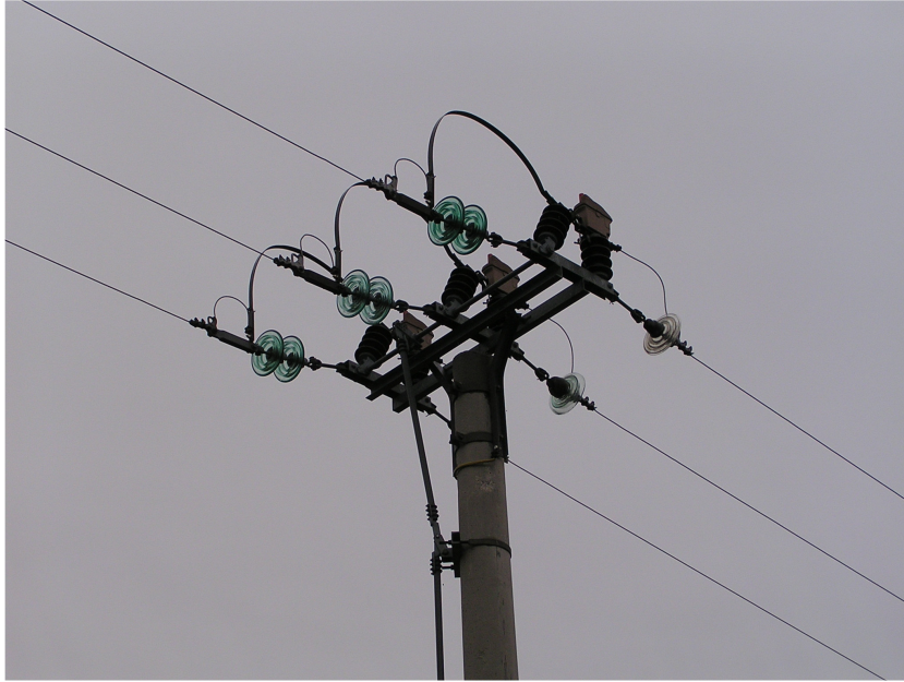
Slika 8. DV 10 kV Voloder; linijski rastavljač
