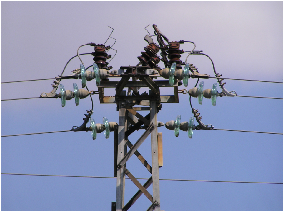
Slika 9. DV 10 kV Dubrava; linijski rastavljač
