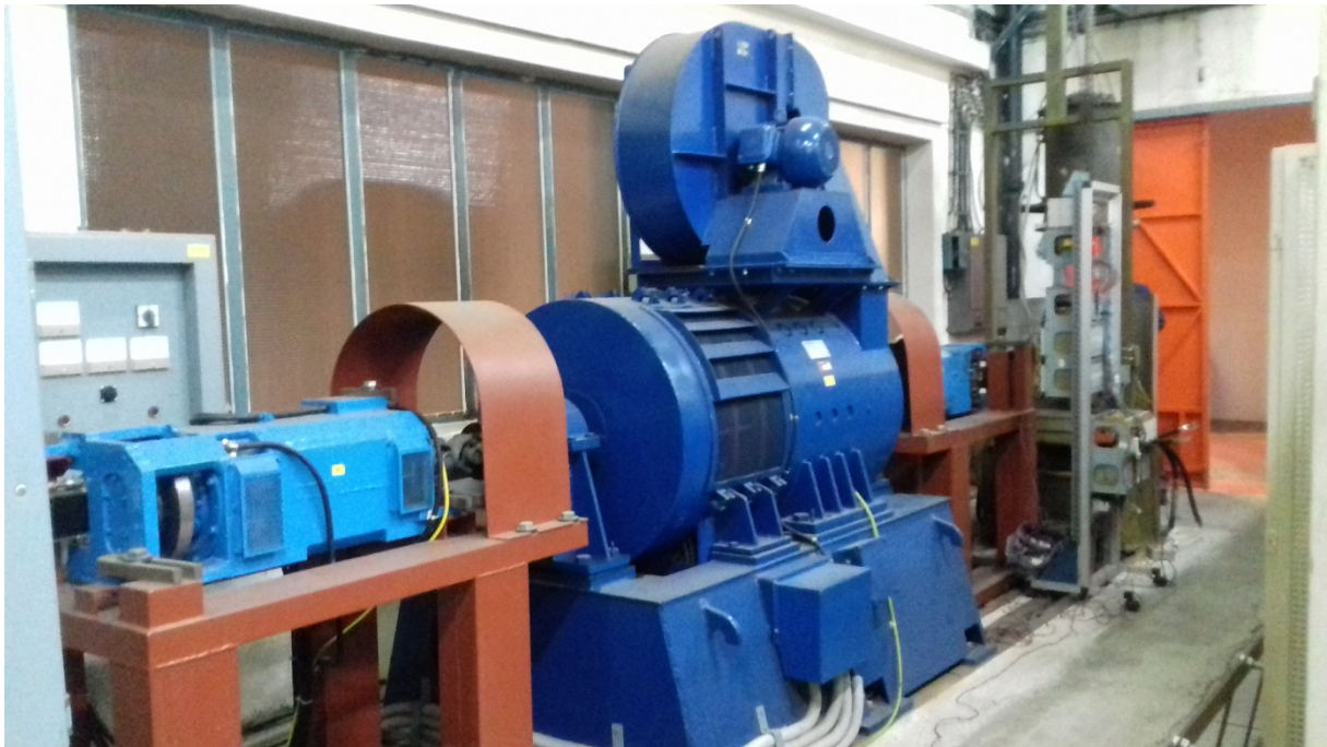
Slika 10.2. Smještaj vučnih tramvajskih motora i opterećenog stroja u strojarnici
