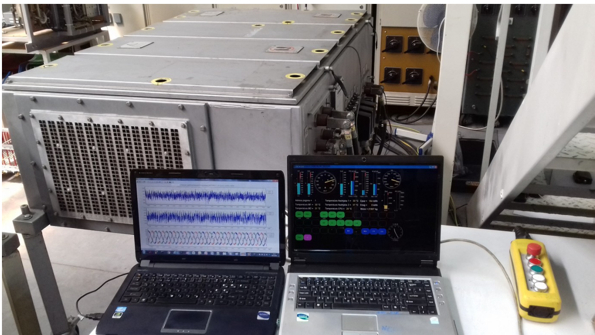
Slika 10.3. Pretvarač glavnog pogona tramvaja serije TMK 2200 za Zagreb, komunikacija s upravljačkom elektronikom i praćenje stanja pogona
