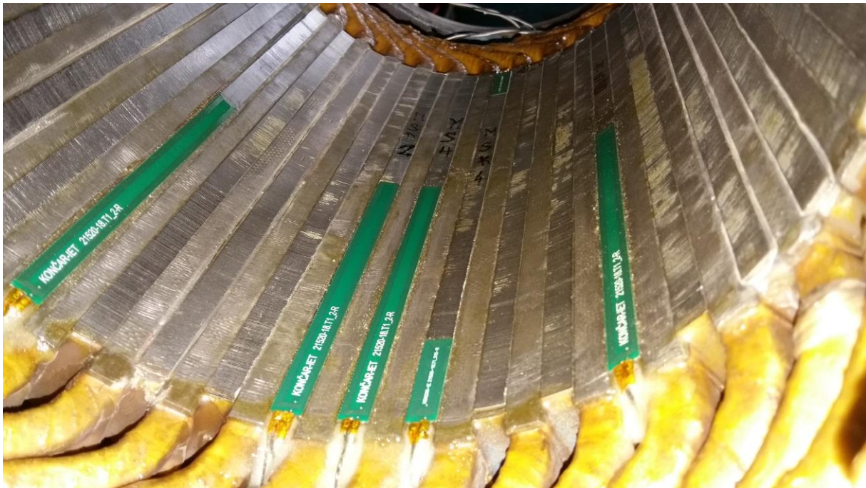
Slika 6.4 Mjerni svici ugrađeni u zračni raspored motora
