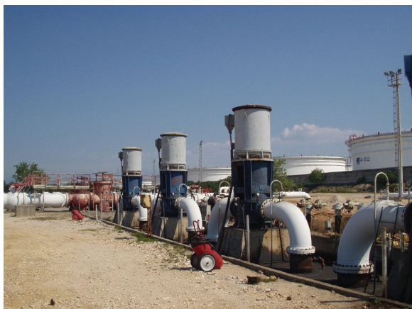
Slika A.1. „Ex e II T3“ motor, 6 kV, 500 kW
