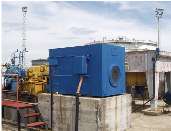
Slika 4.4. Elektromotor u vrsti zaštite povećana sigurnost („Ex e II T3“) u sustavu transporta nafte
