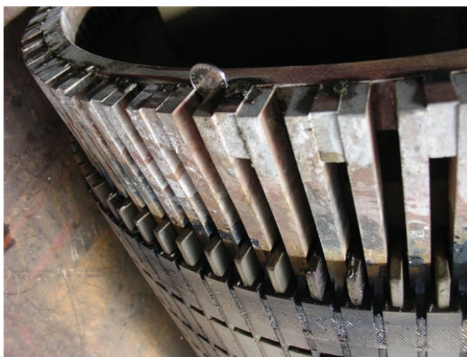
Slika E.1. Oštećenje spoja štapova i prstena
