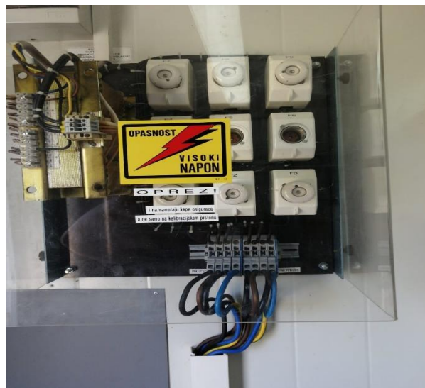
Slika 31. Glavna razvodna ploča (GRP) RD-a i ŽCP-a
