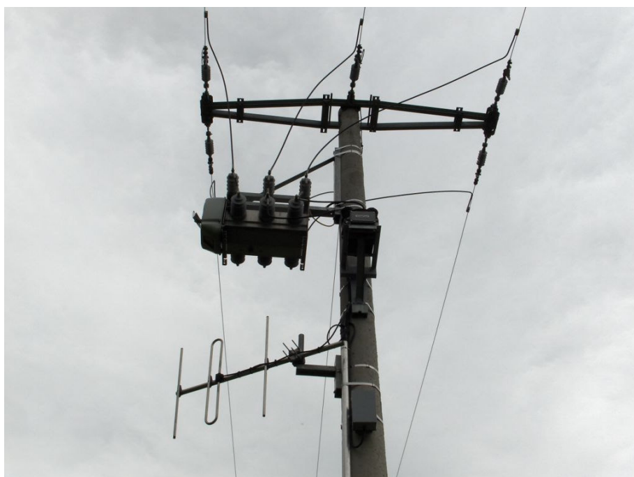
Slika 5. DV 10 kV Voloder; linijski prekidač
