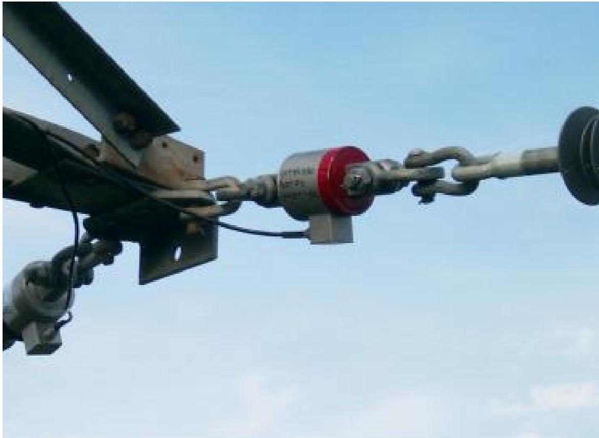
Slika 2.20 Montaža sustava za mjerenje naprezanja vodiča nadzemnog dalekovoda te pripadajuće ovjesne i spojne opreme
