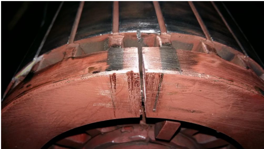
Slika 6.44 Kavezni namot – mjesto prekida prstena rotora
