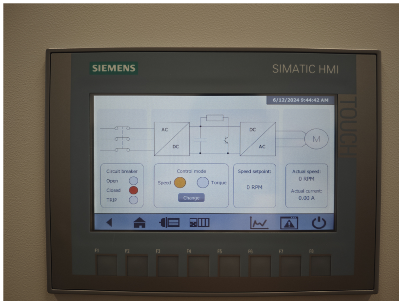
Slika 4.1.4 Panel na elektroormaru
