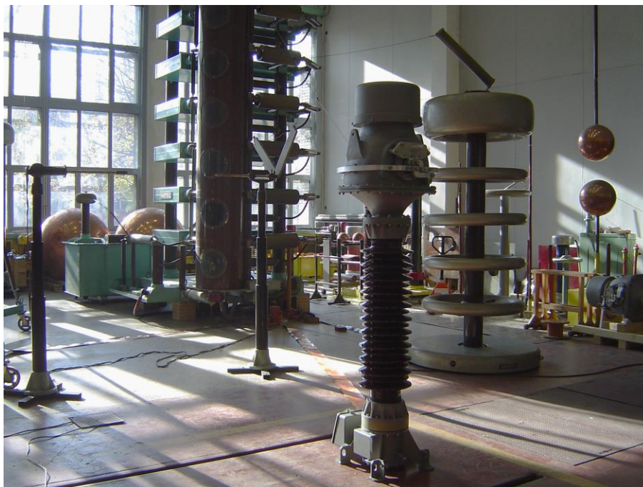
Slika 6.15 – Ispitivanje novog strujnog transformatora udarnim naponom
