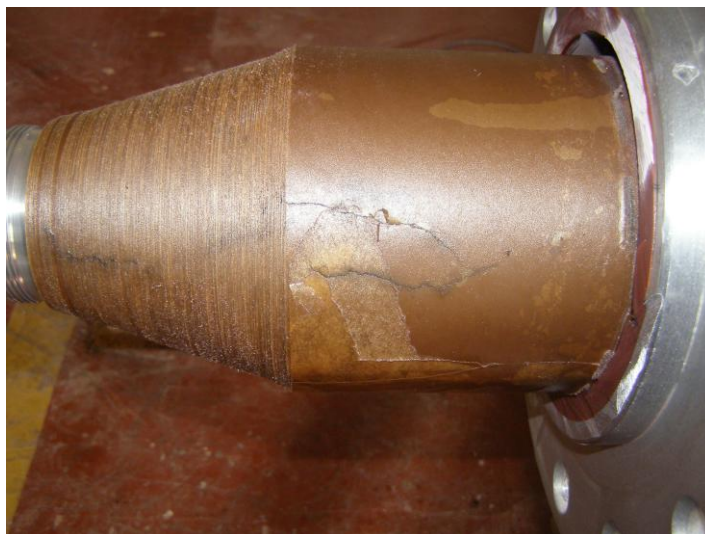
Slika 4.5 – Klizni proboj po papirnoj izolaciji provodnika nakon uklanjanja epoksidnog izolatora
