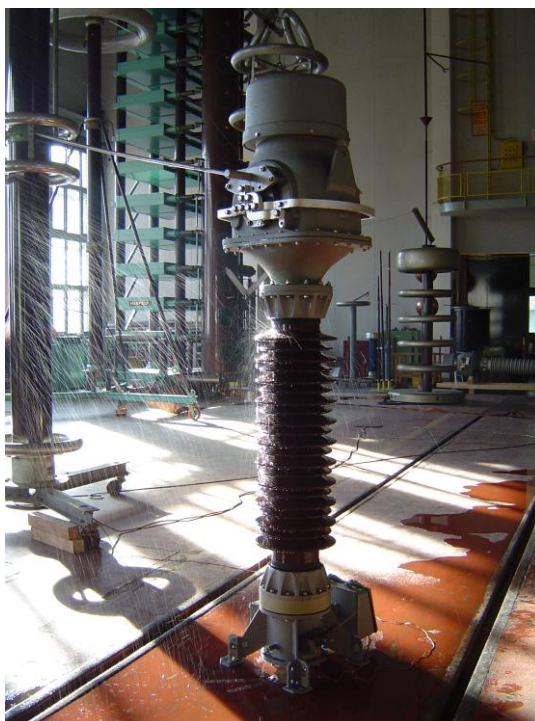
Slika 6.16 – Ispitivanje novog strujnog transformatora podnosivim naponom industrijske frekvencije na umjetnoj kiši
