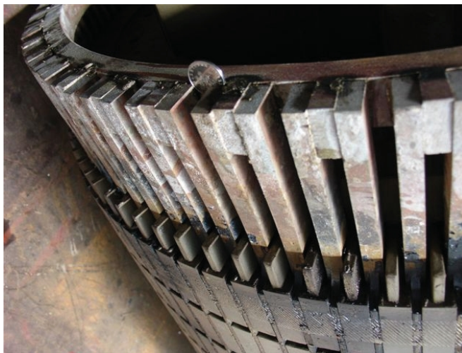
Slika E.1. Oštećenje spoja štapova i prstena
