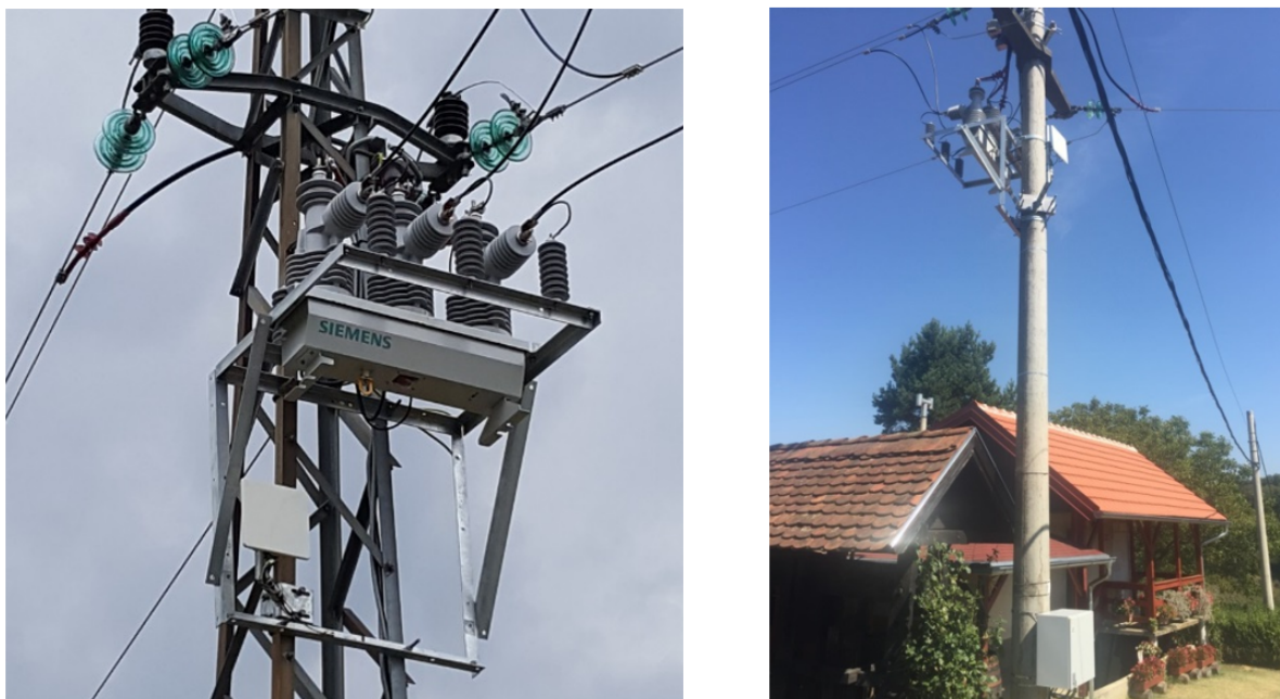
Slika 8.10: Vakuumski prekidač i upravljački ormar
